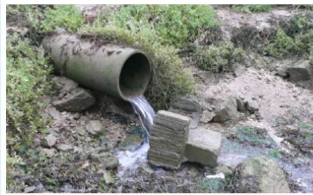
Efluente tipo tubería, con aporte continuo de agua en el tramo B27T8.
